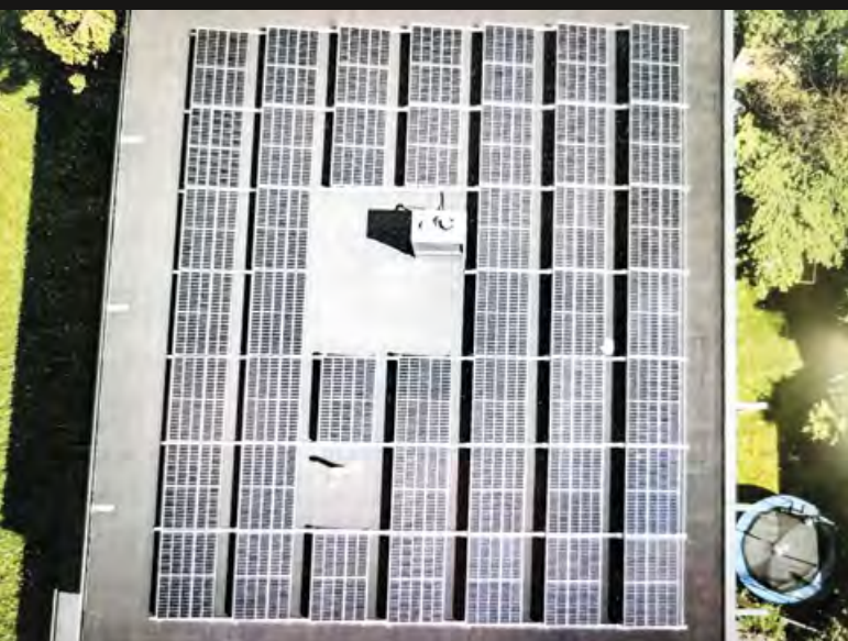
Fotos: Elektroinstallationen Schöpf
