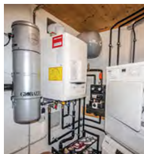
Technikraum und Waschküche sind »benutzerfreundlich« im EG
