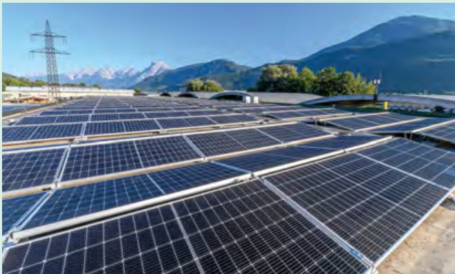
Die Solarmodule auf dem Dach des Firmengebäudes haben nach Umsetzung aller Baustufen eine Leistung von etwa 460 kWp und sollen künftig 35 Prozent des Strombedarfs am Standort Inzing abdecken.
