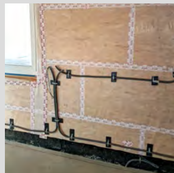
Foto: Offer, Elektroinstallationen Schöpf
